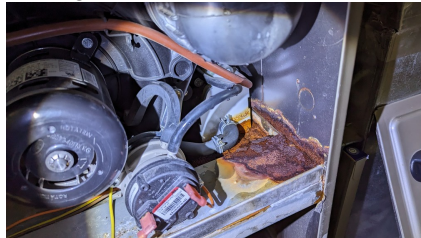
Figure 25: F1 - rust inside unit
