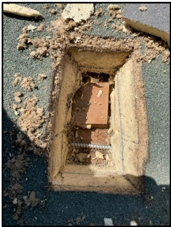
Conduit on Deck
